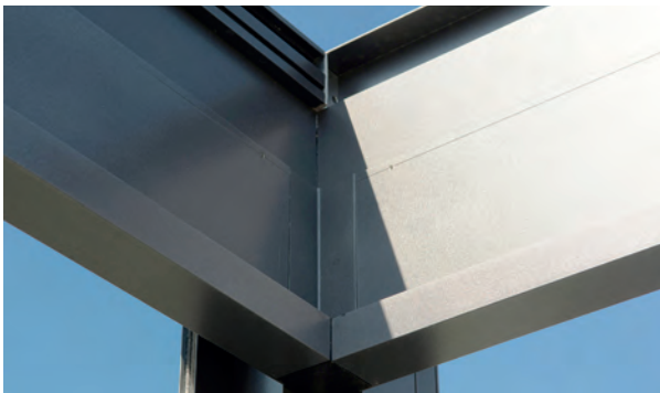
Wasserablauf in der Stütze
